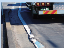
道路盛り上がり
