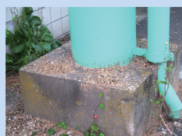
歩道橋鳩糞害
